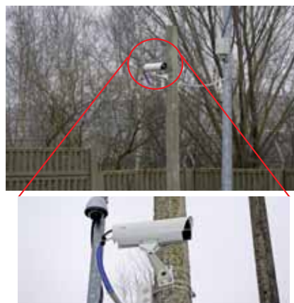
Caméra FLIR Systems série SR installée à ORLEN.
