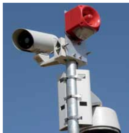
Une caméra thermique FLIR série SR, une balise sonore et lumineuse et un dôme CCTV, installés en un point d'observation.
